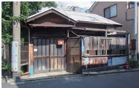
錆びたトタンの外壁
